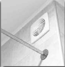
ventilador de baño control
